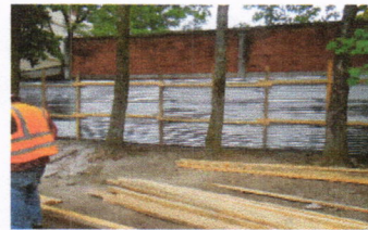
Cercado de instalaciones
