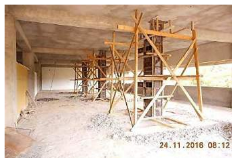
En la imagen se observa encofrado y fundición de columnas tipo C-1 en el 4 nivel, como parte del reforzamiento estructural
