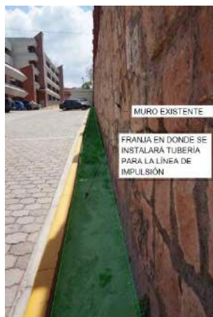
Imagen de franja en donde se colocará la tubería para la línea de impulsión
