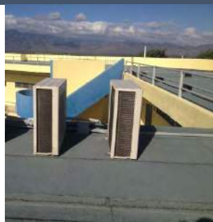
Organización de unidades de aire acondicionado
