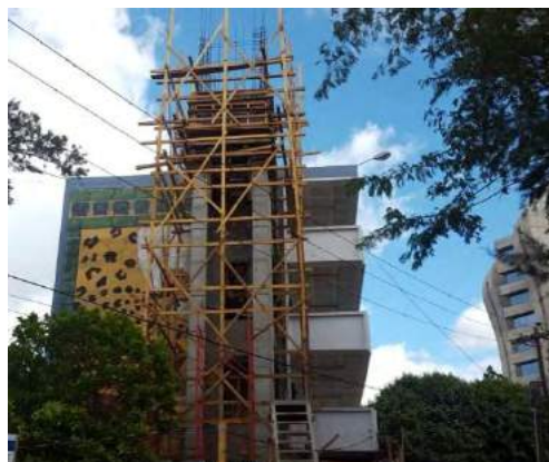
Elevador en Edificio A1, Ciencias Sociales
