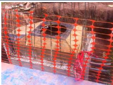
Caja de registro de la Red de Distribución de Media Tensión.
