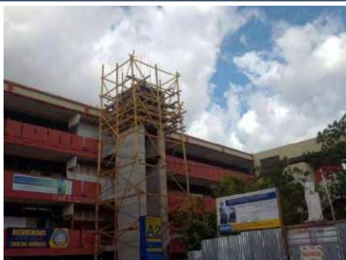
Imagen que muestra la construcción de cubo de elevador en el edificio A2, Ciencias Jurídicas
