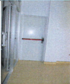
Vista de puerta de salida de emergencia con barra antipánico
