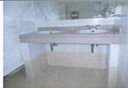
Vista del mueble de lavamanos de baño de mujeres
