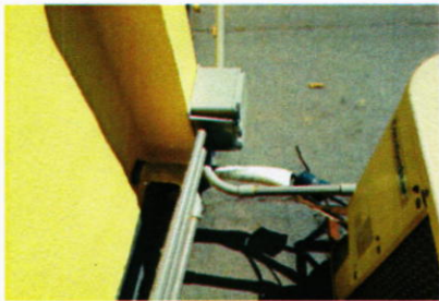
Vista de instalación de unidad de aire acondicionado
