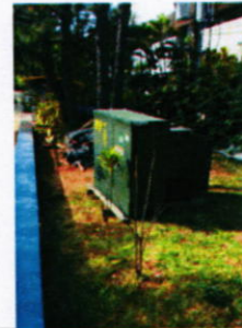
Transformador Pad Mounted ubicado en zona exterior de Biblioteca
