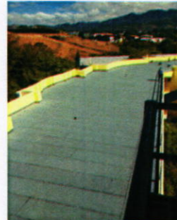
Vista panorámica de Instalación de las membranas impermeabilizantes en azotea 1 y pretiles pintados
