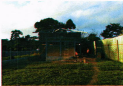
Vista de levantamiento de paredes de bloque de concreto (splitface) en el módulo de desinfección personal (31-01-2017)
