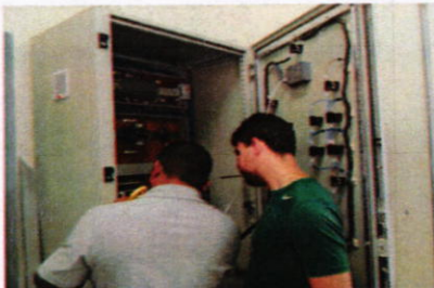
SISTEMA DE AUTOMATIZACION DE EQUIPOS DE BOMBEO DE 30 Y 5 HP
