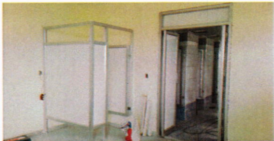
Vista de Sala de Vestidores y Duchas de Hombres en el Módulo de Desinfección Personal (14-08-2017)
