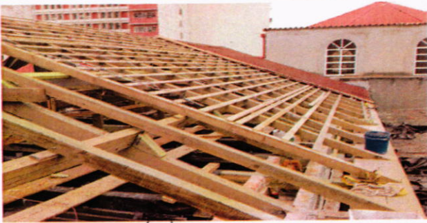
Instalacion de estructura de madera nueva en techo de sectores este y oeste, de igual forma se han sustituido columnas de madera nueva y vigas de estructura de entre piso
