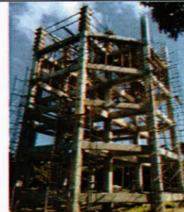
Vista de avance constructivo de tanque. En la parte superior se observa armado de acero y encofrado de columnas de concreto entre nivel 4 y 5; 30-09-2017
