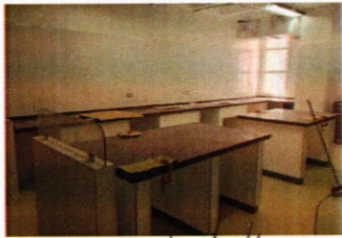
área de lavado de instrumental
