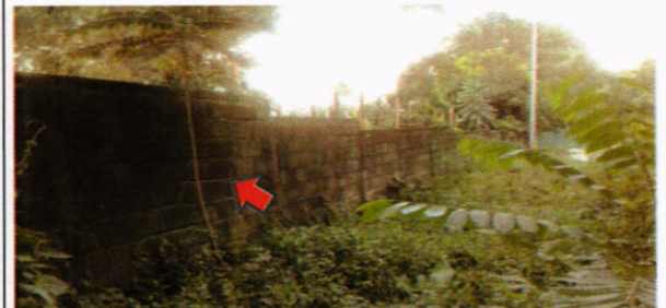
falla en la que se encotraba el muro existente, lo cual obligo a iniciar el proceso de demolicion en este tramo, por aspectos de seguridad
