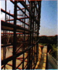
Vista de instalacion del refuerzo de acero de las paredes del tanque; 20-03-2018
