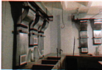
Sistema de ducteria de extracción de cuarto estéril
