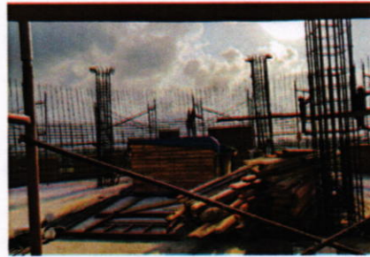
Vista de instalacion del refuerzo de acero de las paredes del tanque; 20-03-2018
