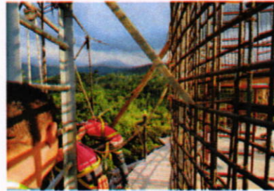
Vista de instalacion del refuerzo de acero de las paredes del tanque; 20-03-2018
