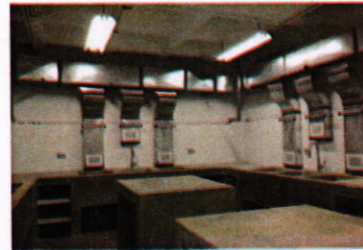
Sistema de extracción en cuarto oscuro, Laboratorio de Rayos X
