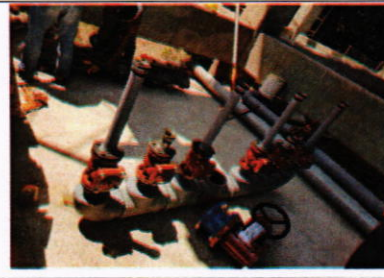
Vista de instalacion de tuberia y accesorios HG de 6" Ø, unidad de filtracion de sedimentos en la linea de conduccion ; 19-04-2018
