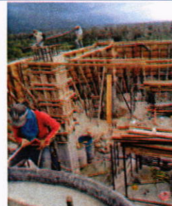
Vista de fundicion de paredes del tanque elevado y columnas internas del tanque; 13-04-2018
