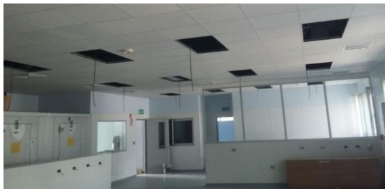
Vista interior área procesos Planta Piloto
