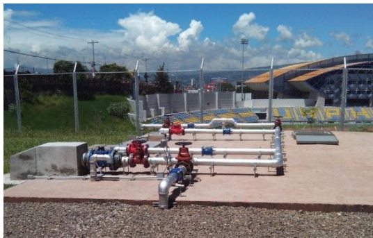
Tubería de impulsión
