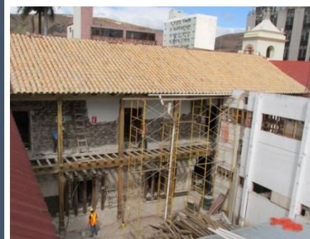
Vista oeste Cambio de techo de teja, reutilizando parte de las tejas existentes sobre la lámina antiderrapante.
