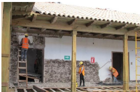
Remoción del repello existente en mal estado para colocar el nuevo repello, el cual se realiza en dos capas de acuerdo a especificaciones.
