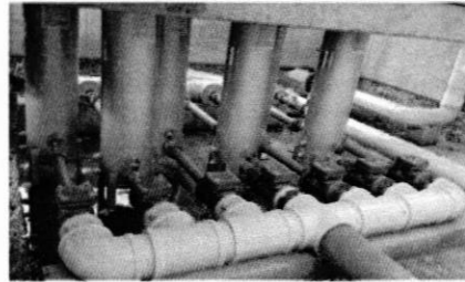
Instalación de Unidad de Filtración de Sedimentos en la tubería de suministro al tanque; 15-08-2018
