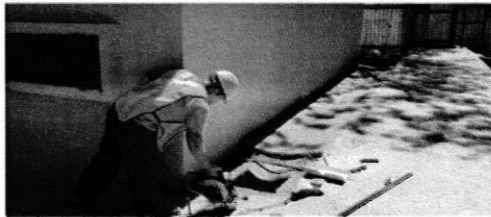
Canal de concreto entre acera peatonal existente y pared de cuarto de bombas
