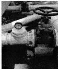
Manómetro y Válvula de Compuerta de Hierro fundido 6"Ø, control de flujo de la entrada de agua al tanque. 30-09-2018
