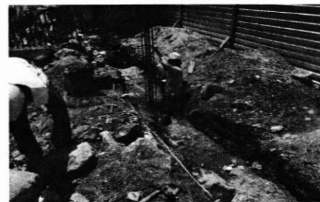
Armado de hierro y encofrado de zapatas aisladas de 80x80x25cms en el sector oeste.
