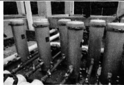
Unidad de Filtración de Sedimentos 30-10-2018
