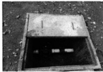
caja de Valvula. Control de flujo de Línea de distribución de agua; 30-11-2018
