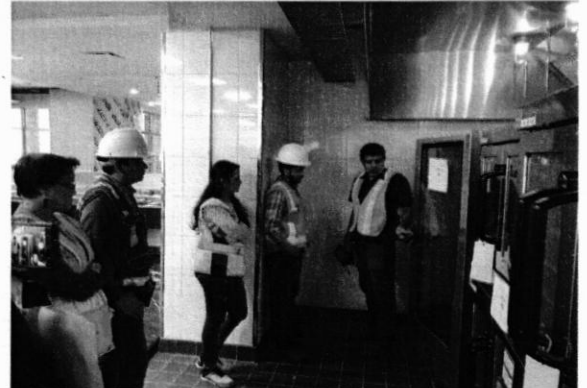
Inducción sobre equipos de cocina instalados.
