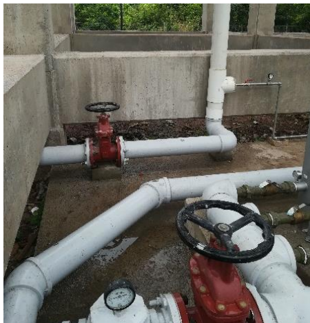
Sistema de Bombeo
