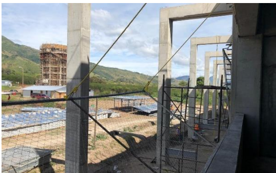
Vista desde Edificio de Aulas hacia tanque de almacenamiento de agua para el campus.
