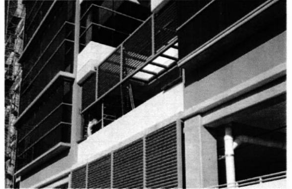
Cerramiento metálico en Módulo A.
