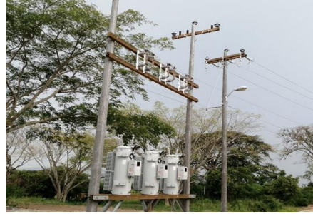
Suministro e instalación de banco de reguladores en media tension
