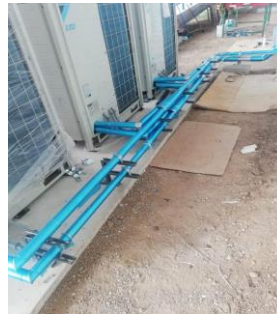
Suministro e Instalación de chaqueta de aluminio para tubería de refrigeración exterior.
