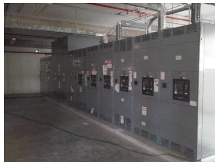
Sub estación Eléctrica
