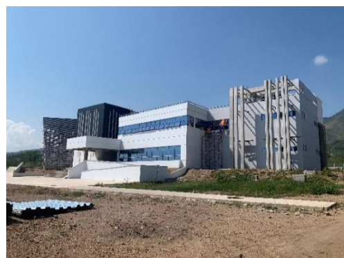
Avance de obra Edificio Administrativo, se construyó el piso de concreto con acabado ashford.
