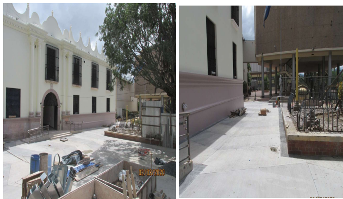
Se encuentra completamente terminada la fundición del piso de la plaza y se trabaja en labores de limpieza
