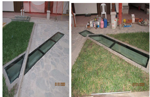
Se hacen correcciones en los vidrios de las ventanas arqueológicas, ya que se observa humedad atrapada por evaporación
