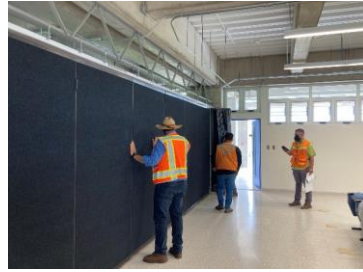
Revisión de la pared divisoria retráctil en Aula Auditorio, Edificio Aulas No.1
