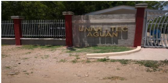
No 3.- Letras encajueladas en pared del muro perimetral
