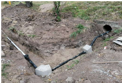
Cajas de concreto para cumplimiento en tubería de agua del pozo a centro CURNO
