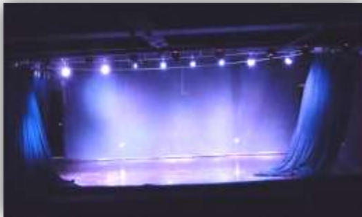
El proyecto se caracteriza por innovadoras instalaciones eléctricas como contadores digitales para los locales de comida e iluminación LED tanto en el teatro como en las áreas de uso público.
